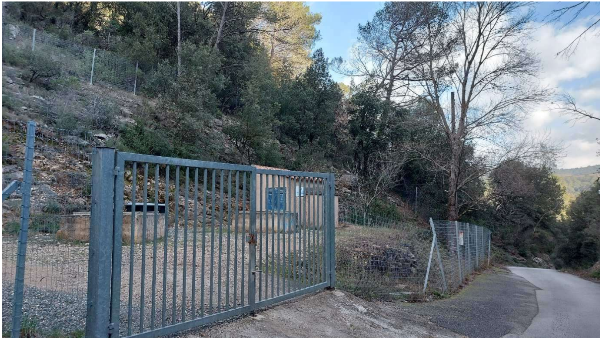
Figure 4. Têtes béton des 2 forages de Vigne Groussière
